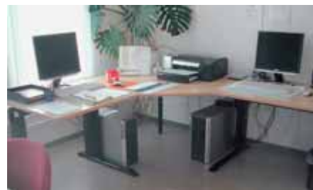
„Hardware des Prozessleitsystems in der Schaltwarte der KA Meerane“
